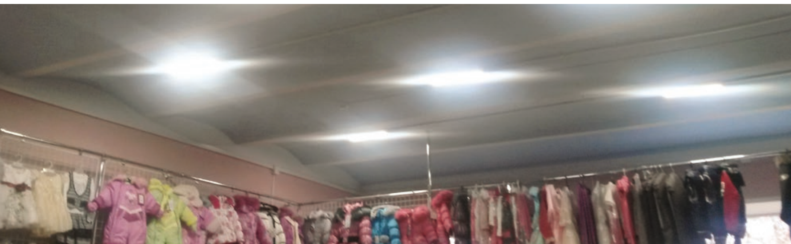
Освещение светильниками серии BOX
