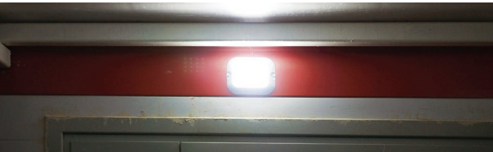
Освещение входа в подъезд дома светильником серии MEDUSA
