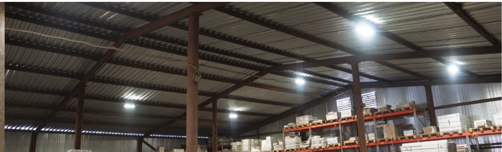
Освещение склада производственного предприятия светильниками серии Plate
