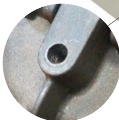
Место дополнительного заземления корпуса
