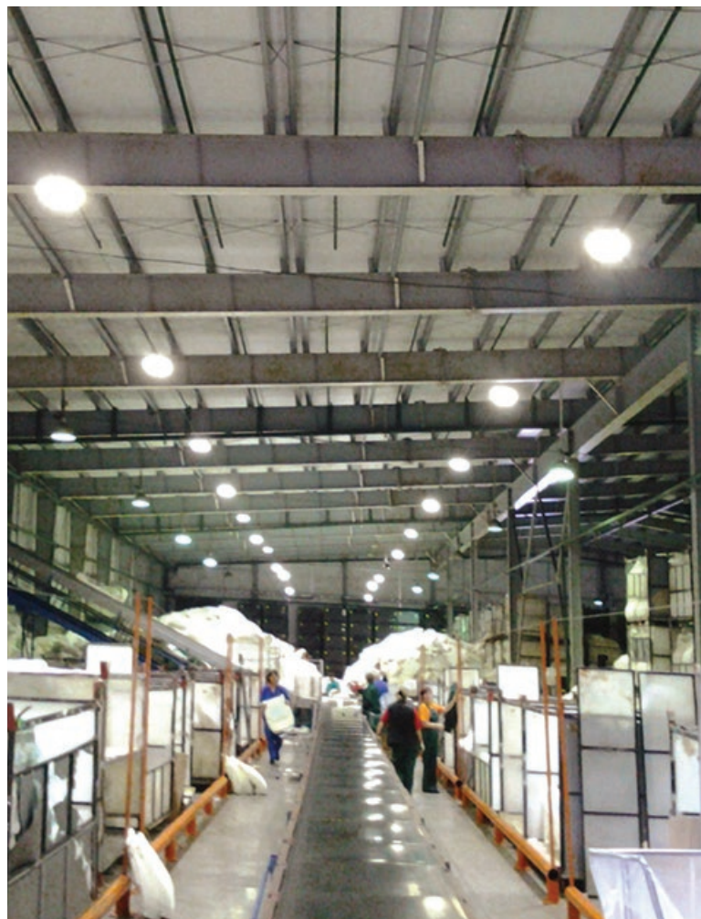
Освещение производственного помещения светильниками WebStar
